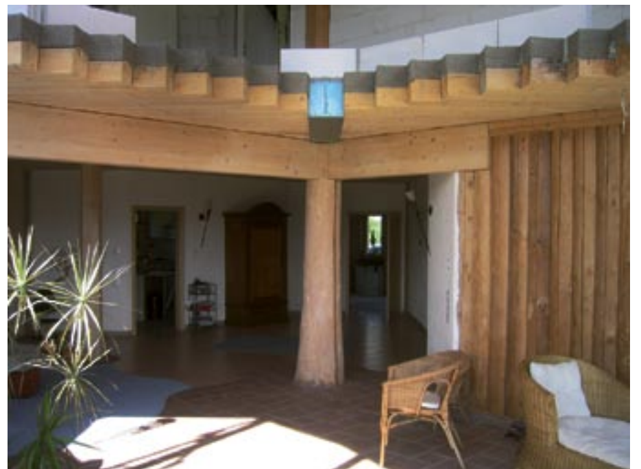
Ein Blick in den Wohnbereich: Gut zu erkennen ist die im Holzpfiler mit der Motorkettensäge eingebrachte Entlastungsnut! Anfangs noch 6 mm, ist diese nun auf ca. 4 cm „herangewachsen“!
