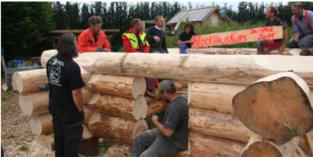
• Nach den ersten Stammlagen freuen sich die Kursteilnehmer über das zügige Fortschreiten des Bauvorhabens.
