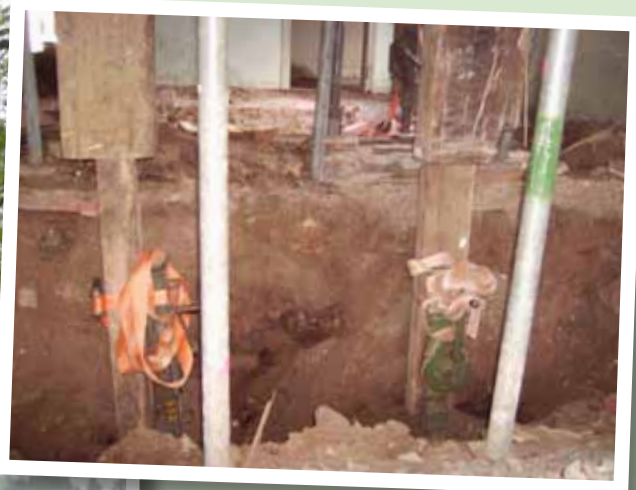
• Besonders aufwendig war die Nachfundamentierung der meisten Wände durch die vorhandene Torfschicht hindurch bis auf tragfähigen Baugrund.
