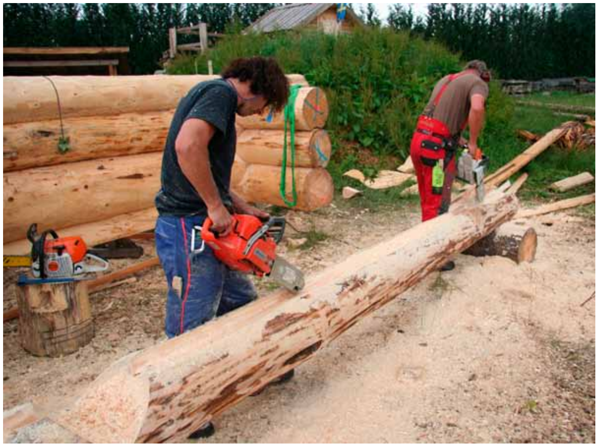
• Mit der Scheibenfräse werden die ausgesägten Konturen verfeinert; hier die Längsnut für die Schafswolldämmung.
