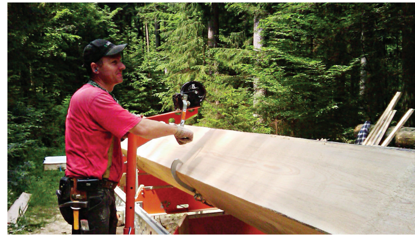
• Vor Ort im Wald des Schwagers werden die Weißtannenstämme zu sauberer Schnittware gesägt: 4,5 x 16 x 500 Zentimeter lange Bodendielen. Mit dem Stammlader lassen sich auch große Stämme wie die Weißtanne mühelos drehen.
