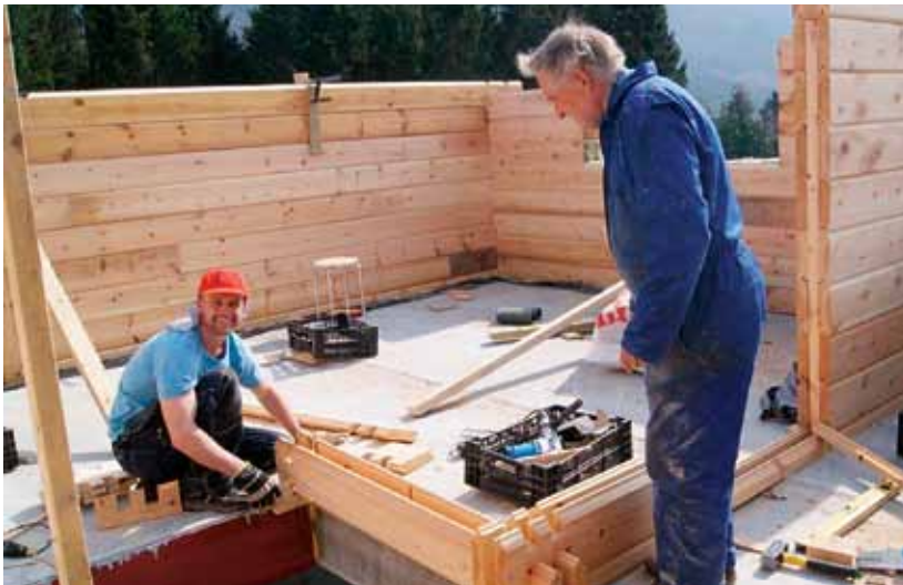
• Isolasjonen i den doble plankeveggen er en type som gir høyeste isolasjonsverdi.
