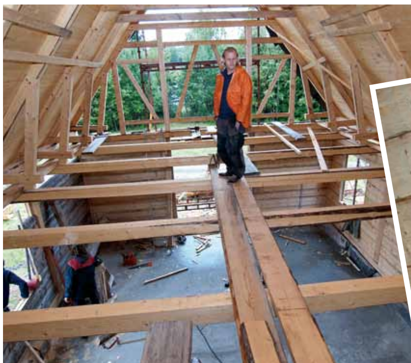
• Bjälklaget ska förstärkas med en metod som gör träbalkar starkare än stål.
